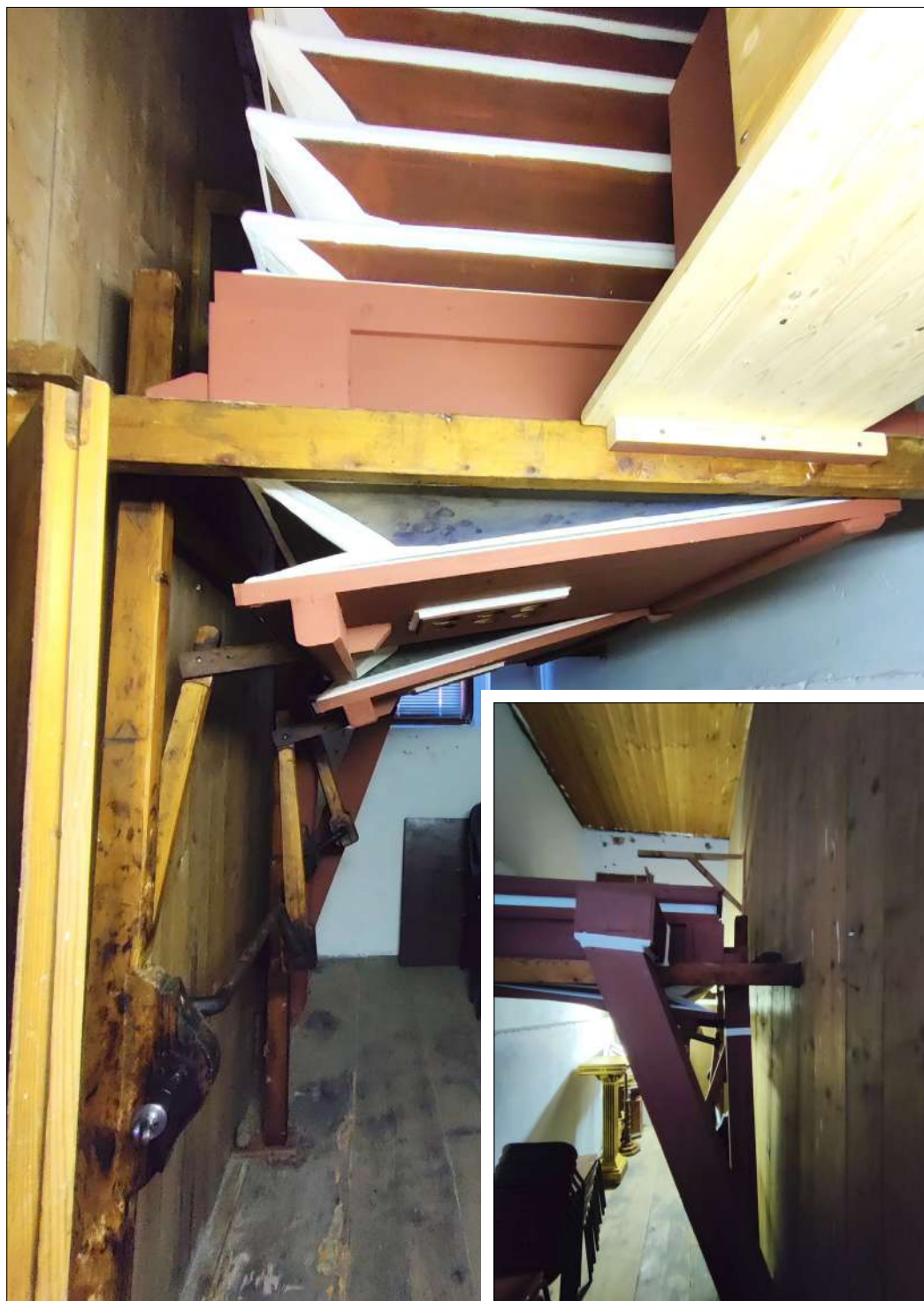
Foto 14. Pompe di caricamento dell'aria
